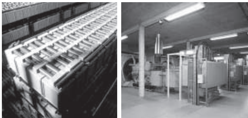
Fig. E18: Ejemplos de fuentes de alimentación de reserva: acumulador central (izquierda) y generador diesel (derecha).
