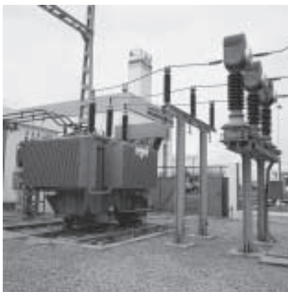
Fig. B25: Transformador con depósito de expansión.
