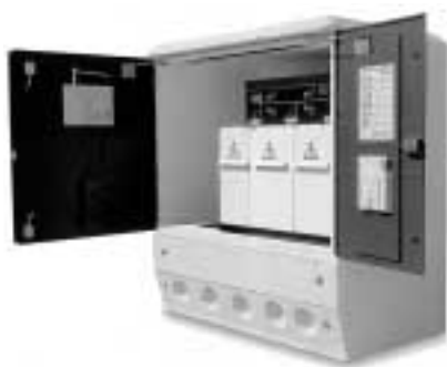
Fig. B35: Centro en prefabricado con maniobra exterior.
