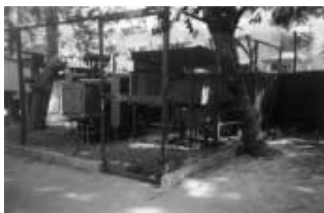
Fig. B36: Subestación de exterior.
